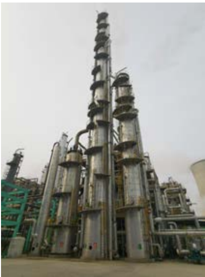
低温甲醇洗涤塔及排气筒
