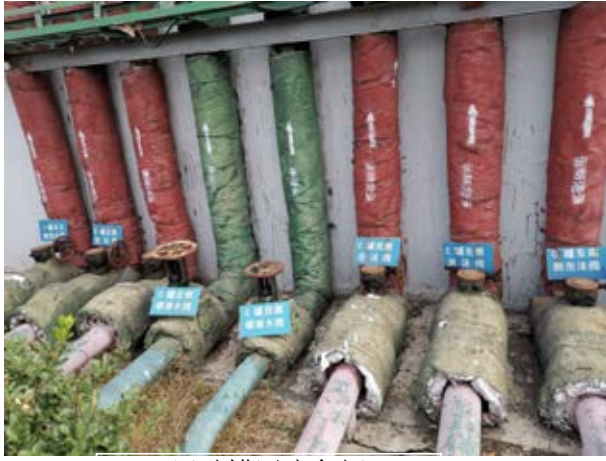
甲醇罐区应急阀
