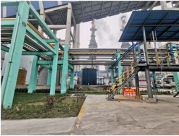
硫酸罐区及装填区
