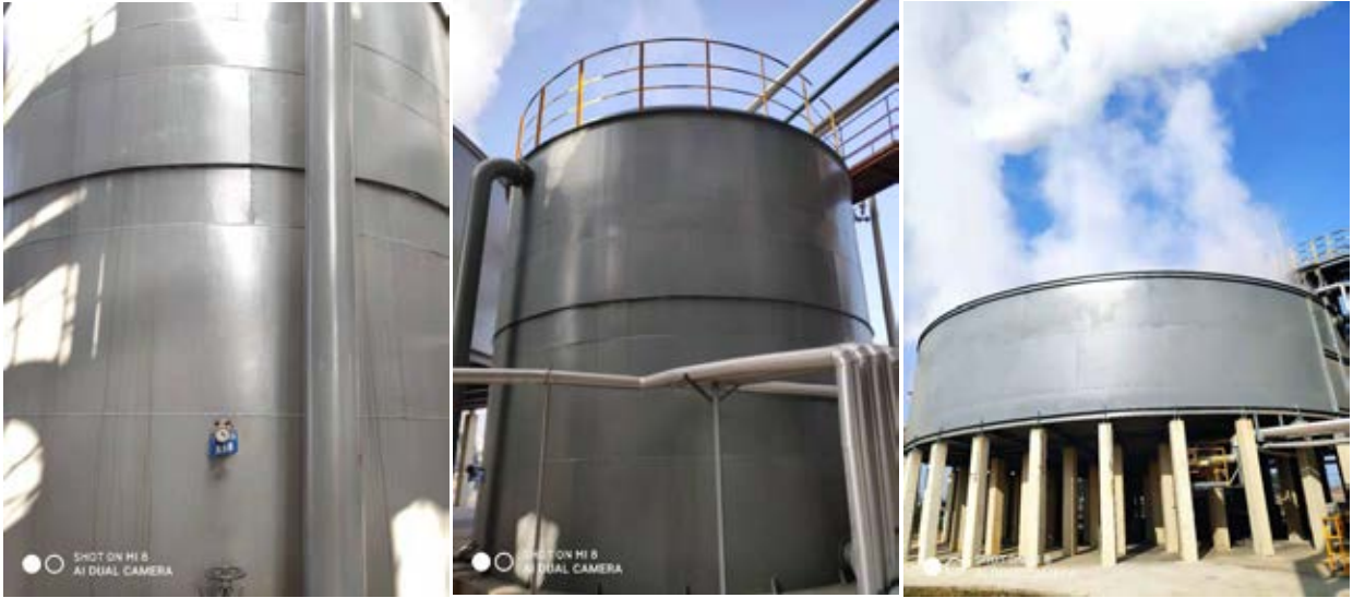
气化灰水沉降池
