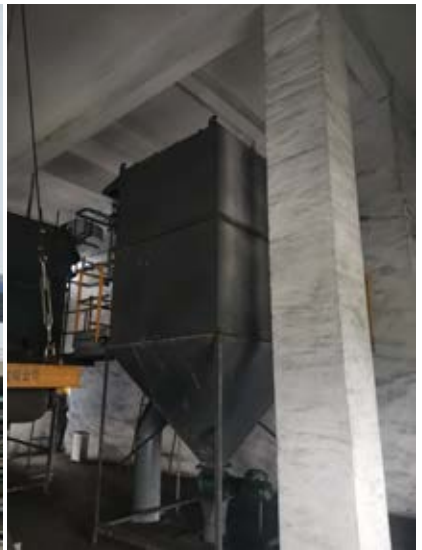
碎煤机除尘器
