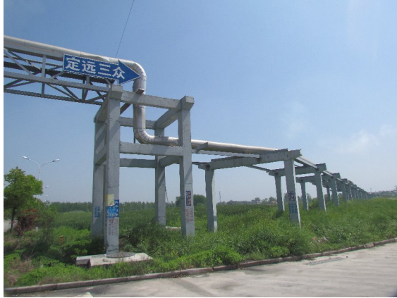
外供园区蒸汽、氢气管网
