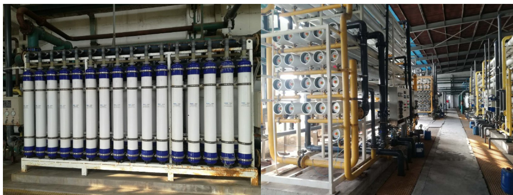
泉盛公司反渗透过滤装置
